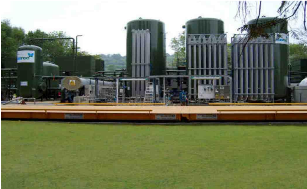
Figuur 17: Gasrec's 5,000 ton/jaar LBM productie installatie in Surrey (UK)
