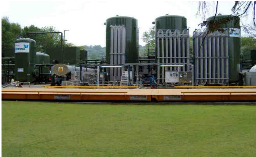
Figuur 17: Gasrec's 5,000 ton/jaar LBM (bio-LNG) productie installatie in Surrey (UK)
